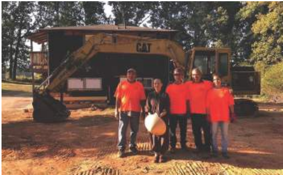
Ni sư Trụ trì cùng thợ đang đào móng xây Chánh điện mới 2020
